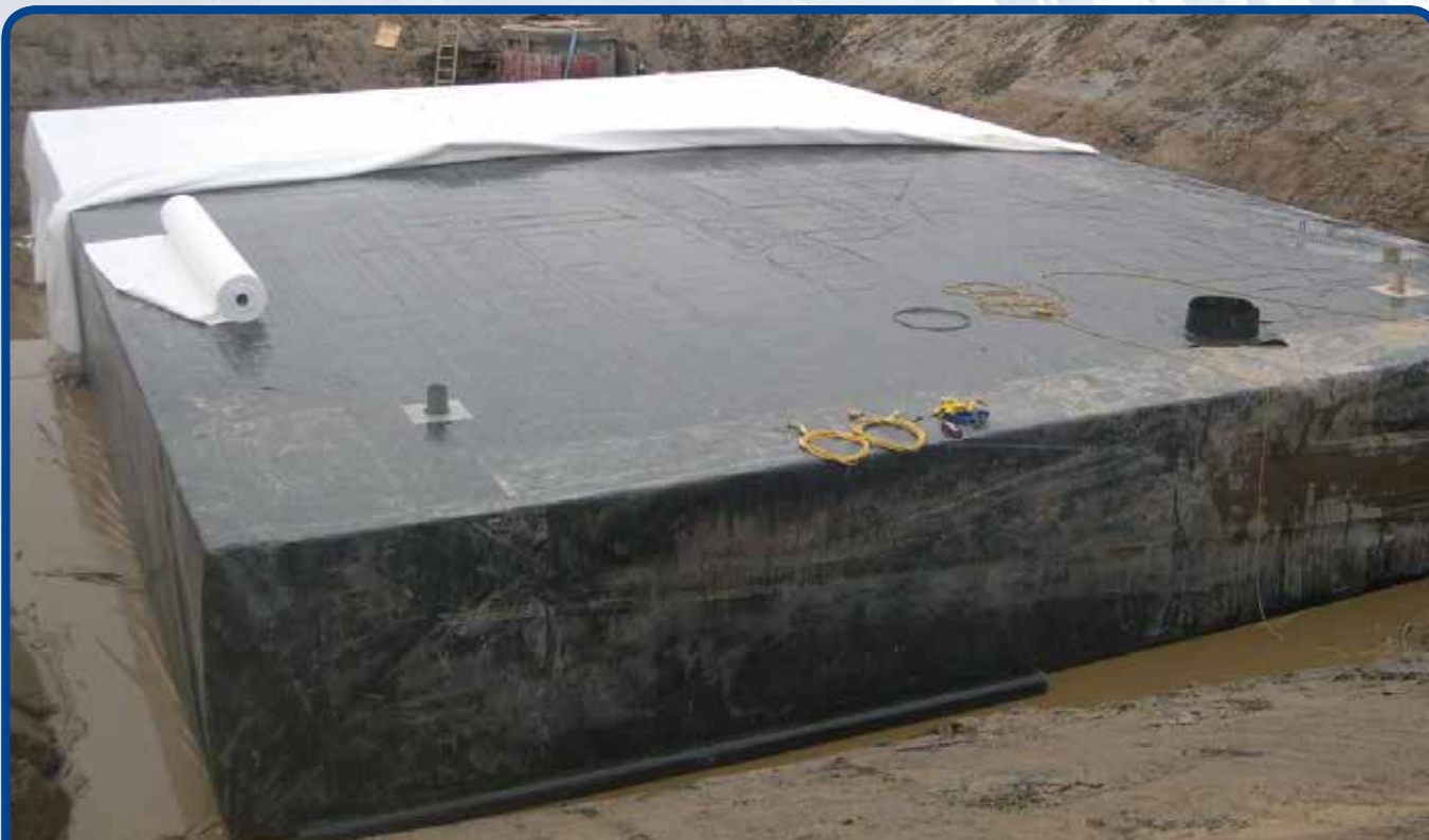
Fördröjningsmagasin 280 m 3 , trippelmoduler
